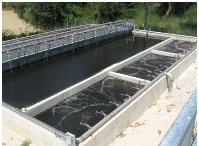
Trattamento terziario in lagunaggio aerato tricamerale
