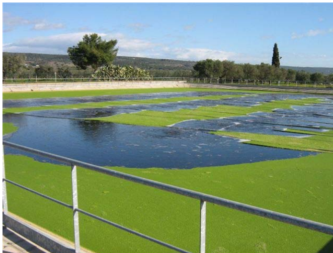
Trattamento terziario in lagunaggio aerato
