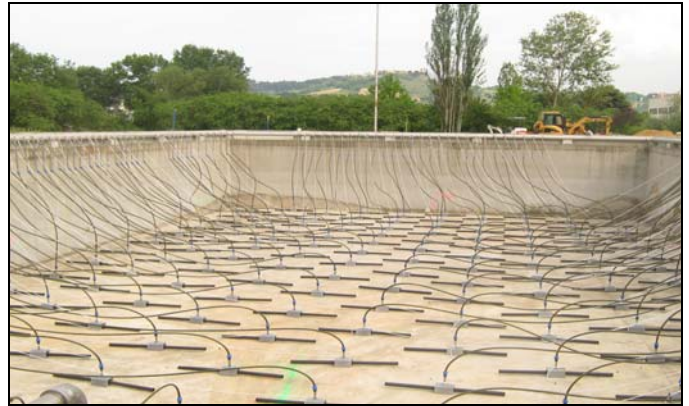
Aeratori gravitazionali nel bacino di Rigenerazione
